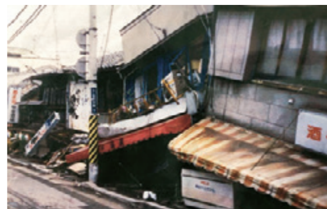
最も被害が大きかった神戸市長田区
