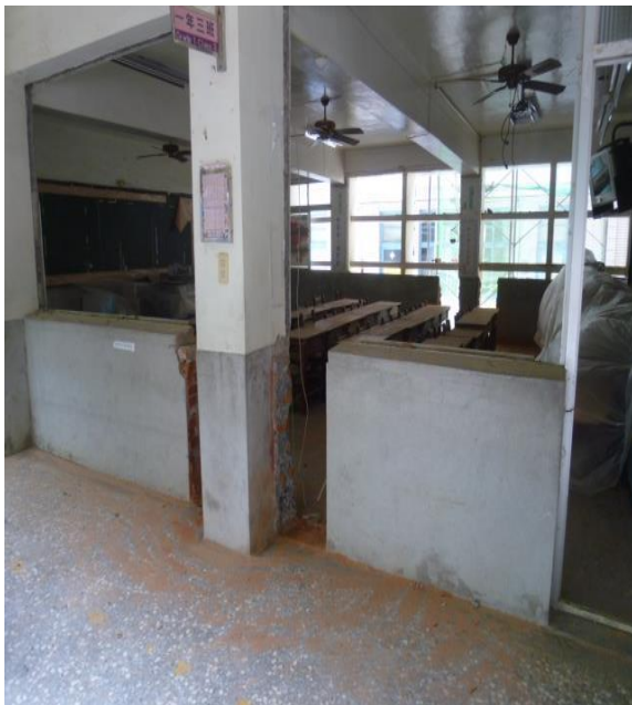
短柱構造の影響により、被害を受けた教室
