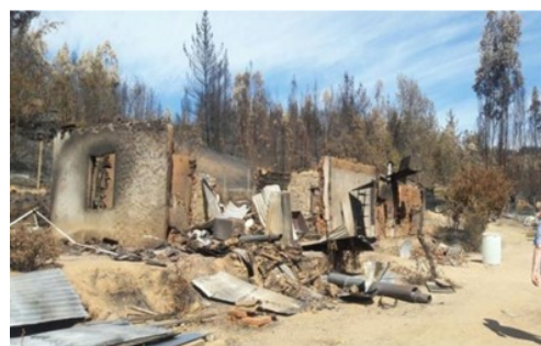
火災により被災した家屋の様子 ©IFRC
