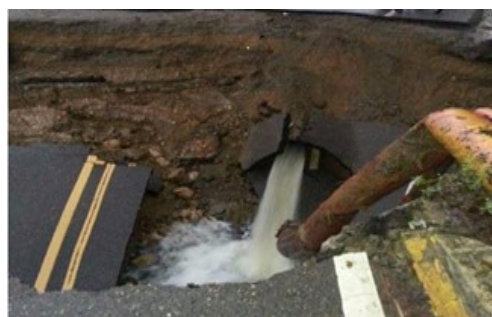
大雨の影響により崩壊した道路の様子 ©IFRC
