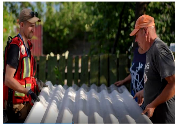
キーウ ククハリにて屋根の修繕を支援する赤十字スタッフ (C) ウクライナ赤十字社
