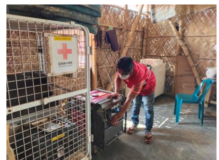
発電機の点検をするアブルさんのバングラデシュ赤新月社
