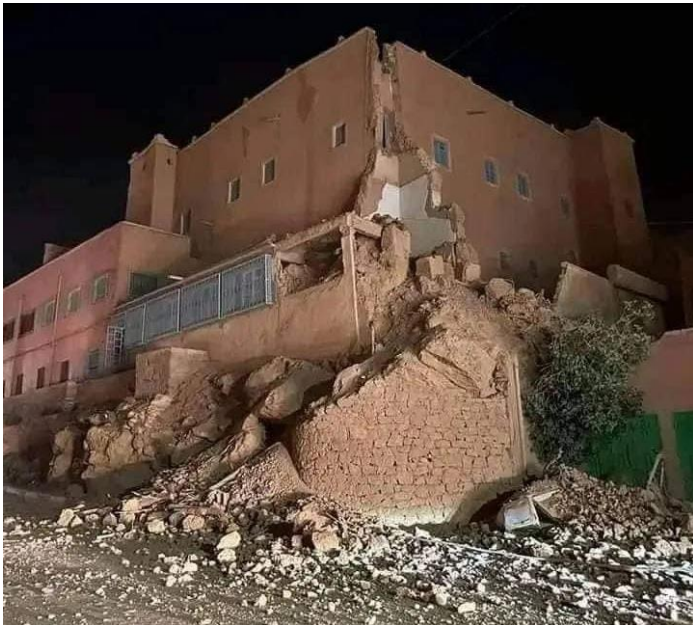
地震の影響で損壊した建物©モロッコ赤新月社
