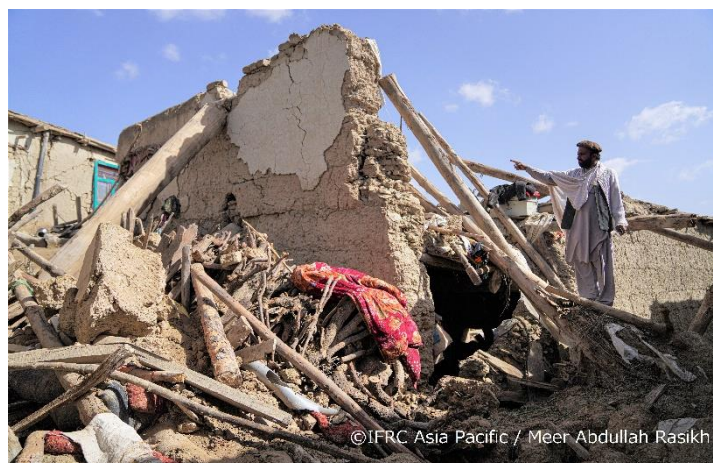
地震被害で倒壊したパクティカ州の家屋
