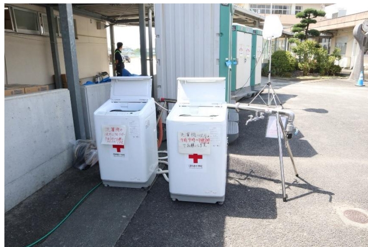
設置された給水機材及び洗濯機 （熊本県 八代市）
