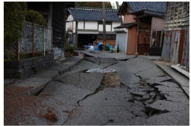
令和6年能登半島地震による地盤沈下とマンホールの隆起©渋谷敦志
