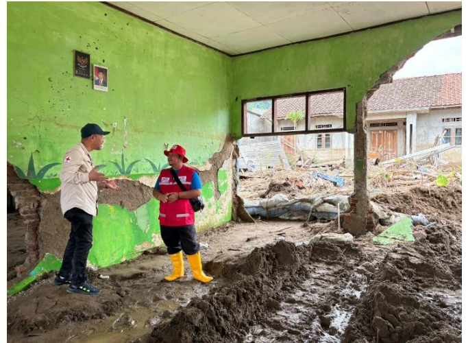
洪水で壊滅的な被害を受けた学校(スカブミ県)
