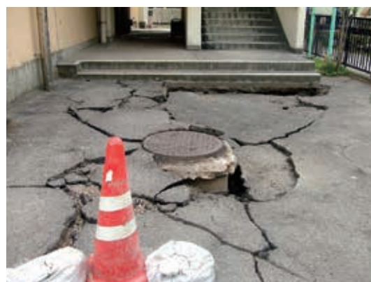
液状化で損壊したマンホール
