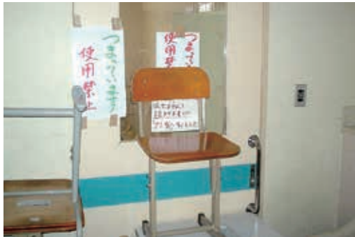
詰まって使用できないトイレ
