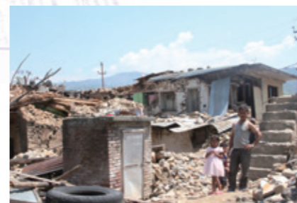
壊れた家屋の前で立ち尽くす人。メラムチ村周辺は9割の家屋が倒壊していた
