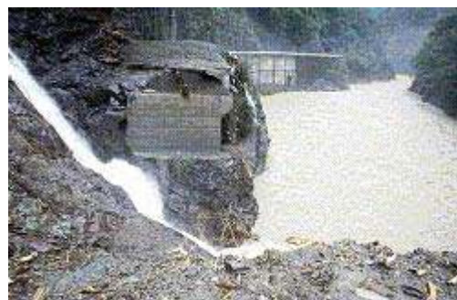
土砂崩れで流出した橋（木沢村） (徳島新聞社提供)
