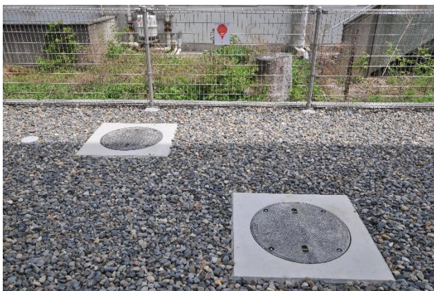
おすいそうのマンホール
