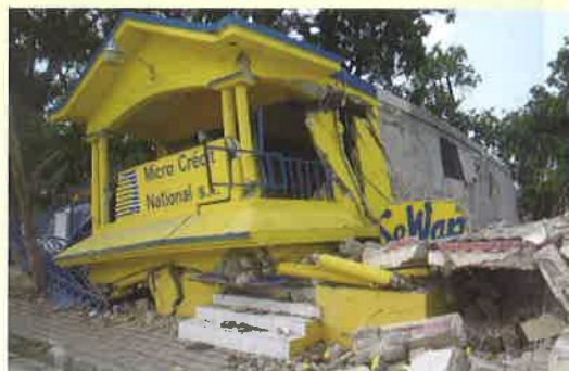
地震でパンケーキクラッシュ状態に崩壊した建物
