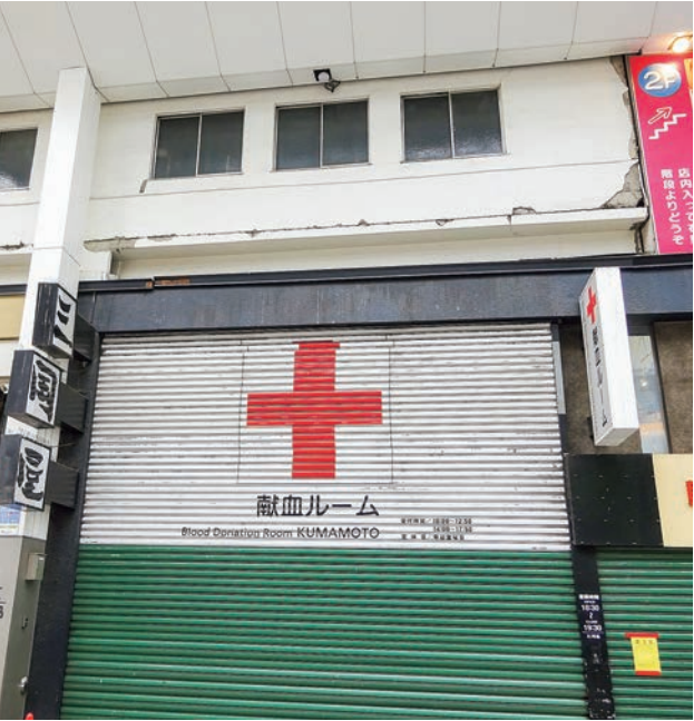
外壁や内装にかなり損傷をうけた下通り献血ルーム
