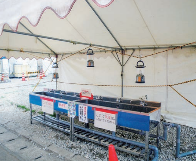
益城町総合体育館敷地内の洗面用水道設備
