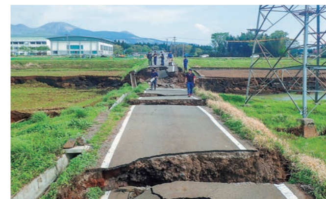
亀裂の入った道路(阿蘇市の石) (提供:阿蘇市)
