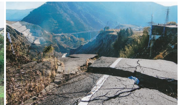
山腹崩落により断裂された国道57号(立野) (提供:阿蘇市地域赤十字奉仕団)
