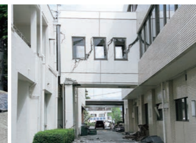
甚大な被害を受けた益城町役場
