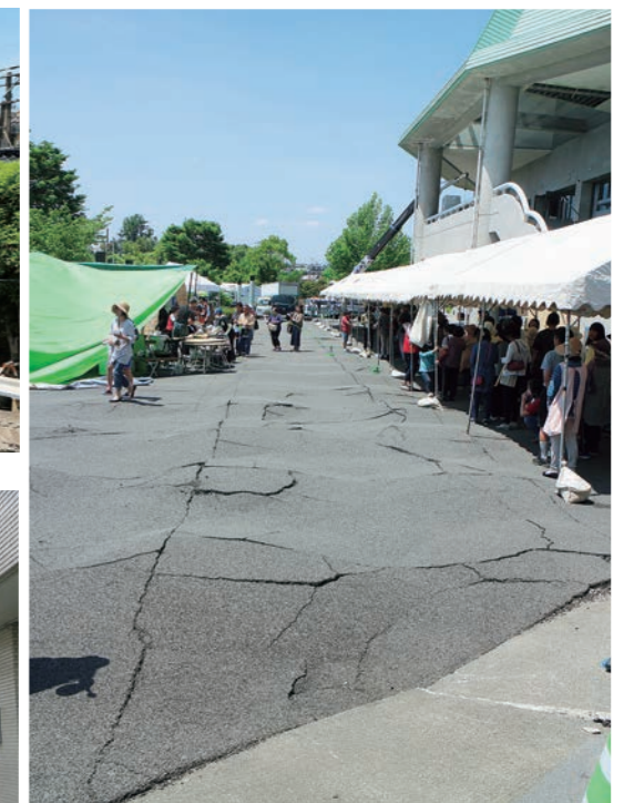
正面玄関前が地割れした益城町総合体育館
