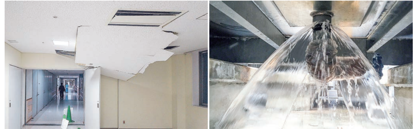
食堂横の天井が崩落
