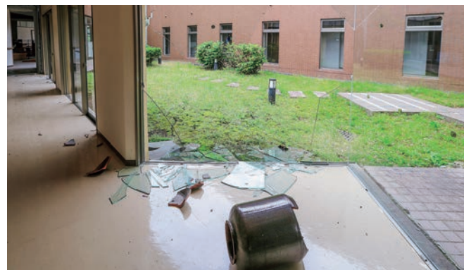
割れた強化ガラスの窓
