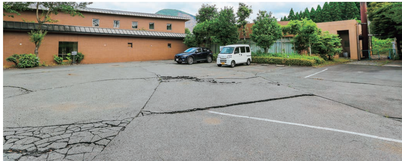
無数の亀裂が入ったアソシエートのアスファルト
