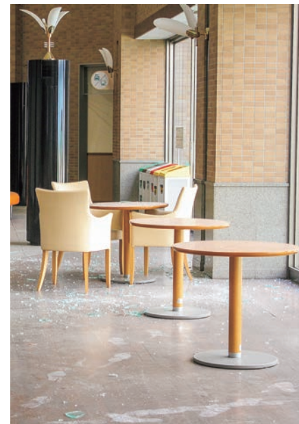
ガラスが飛散した病院1階ロビー
