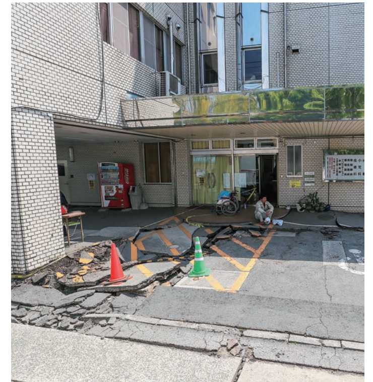
激震により病院機能が停止した、東熊本病院(益城町)
