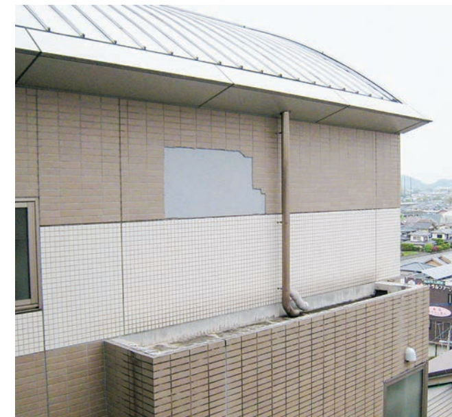
タイルが剥げ落ちた健康管理センターの壁面
