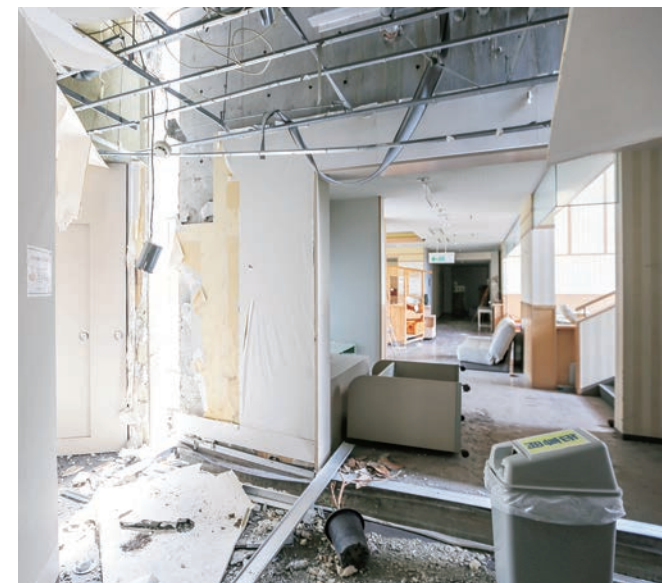
床の段差と隙間が生じたアソシエートの本館と別館のジョイント部分
