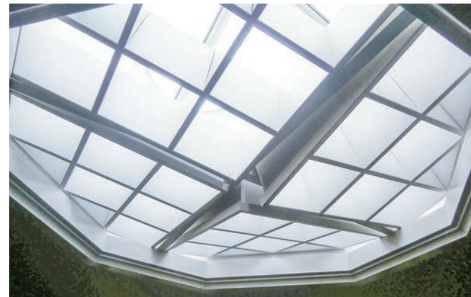
崩落寸前の天窓
