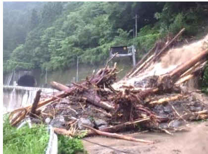
②(香美市) R195 月谷と榎山トンネル間の土砂崩れの様子
