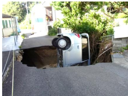
④(大月町)柏島地区の道路陥没による車両転落の様子
