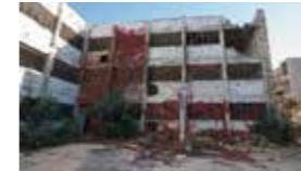
爆撃により崩壊し、静寂に包まれた学校 シリア・ホムス
