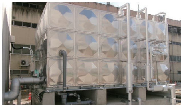
受水槽（地域災害拠点病院施設整備費補助金）
