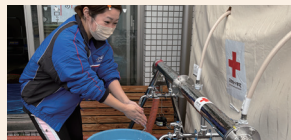
避難所に浄水・加温機器を設置
