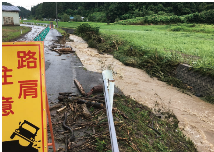
由利本荘市北ノ股地区の被害状況
