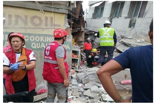
地震による建物倒壊現場での捜索救助活動 ©フィリピン赤十字社
