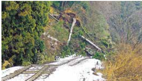
のり面の崩壊で寸断された線路
