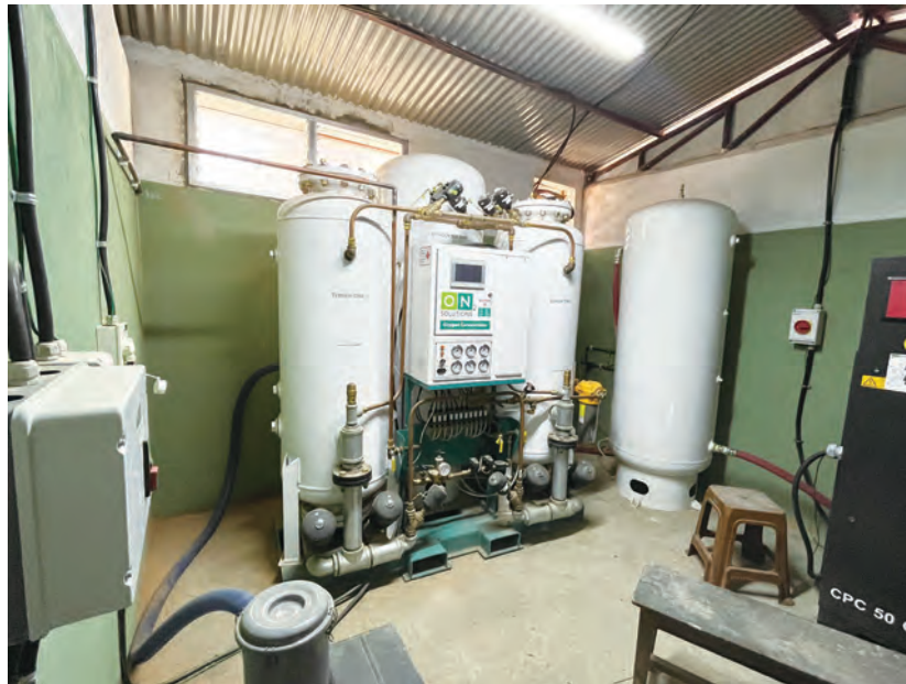
病院内の格納庫に設置された酸素生成プラント
