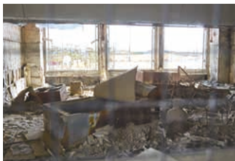
校舎1階、当時職員室だった一角。卒業式直前で金庫には卒業証書が。震災後、金庫をこじ開けて証書を取り出した形跡が残っている
