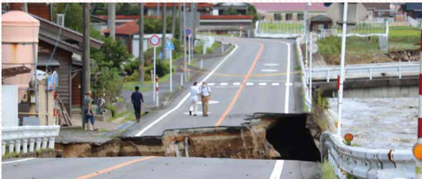
鳥取県では、水害により一部の橋や道路の路肩が崩落、断水や停電も発生した
