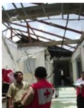
屋根が吹き飛んだ建物の状況を調査する ミャンマー赤十字ボランティア
